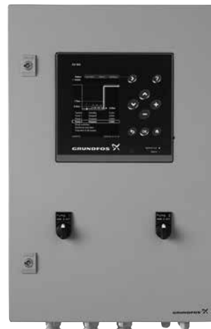
Рис. 30 Шкаф управления Dedicated Controls
