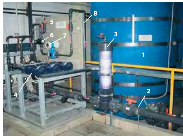
Рис. 101. Дозирование раствора гипохлорита натрия с использованием насосов BN фирмы Seerex.
