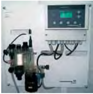
Рис. 111. Измерение свободного остаточного хлора с использованием анализатора Conex DIA-1 и ячейки AQC D1 на Подольском водоканале.
