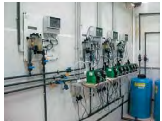
Рис. 118. Система водоподготовки и дезинфекции воды в бассейне (г. Старый Оскол).
