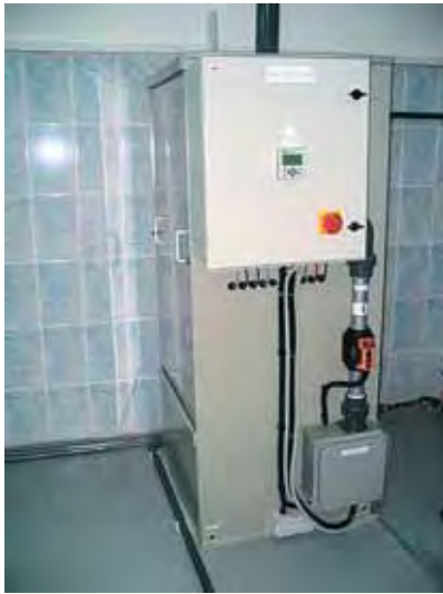
Рис. 89. Установка Selcorperm 195-125. Подольский Водоканал.
