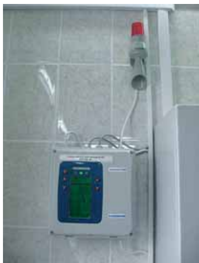
Рис. 97. Система контроля и сигнализации водорода в воздухе рабочей зоны
