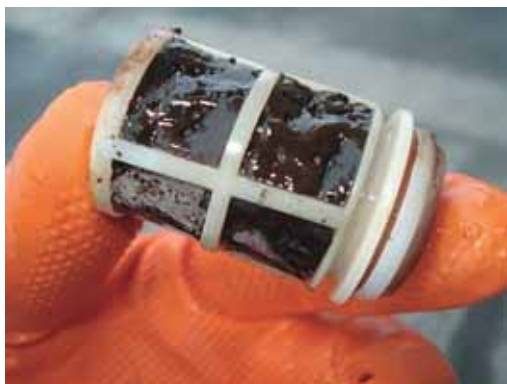
Рис. 37. Сетчатый фильтр установки Selcoperm 125 загрязнённый гидроокисью железа.
