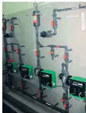
Рис. 103. Станция дозирования гипохлорита натрия с использованием мембранных насосов DDI 222.
