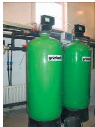
Рис. 94. Установка умягчения воды. Водоканал г. Сыктывкар.
