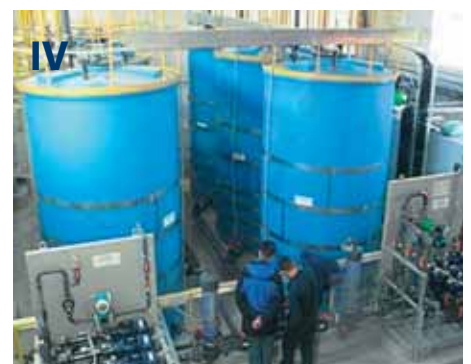
Рис. 88. Цех по производству раствора гипохлорита натрия (0,8%) Водоканал г. Сыктывкар. Установки: 1 - Selcoperm SES 5кг – 2 шт. 2 - Selcoperm SES 20кг – 2 шт.
