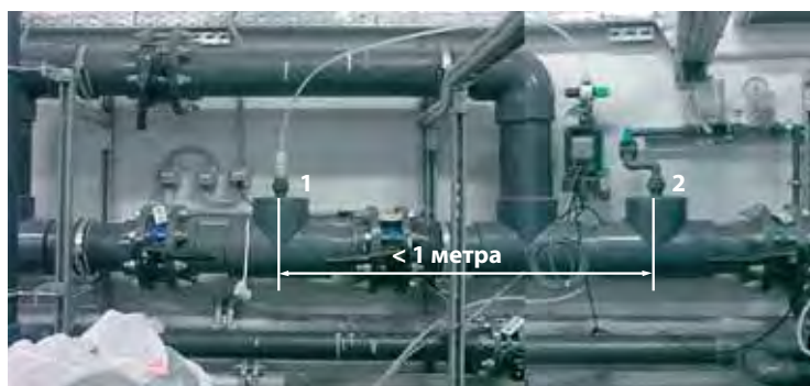
Рис. 128. Монтаж узлов: ввода реагента (1) и отбора пробы воды (2), не обеспечивающих полного смешивания реагента с водой.
