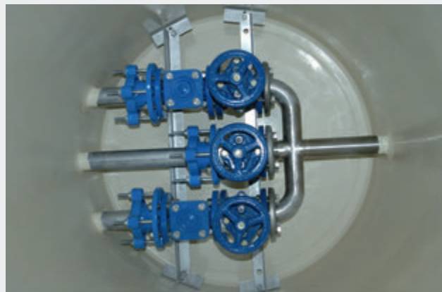
Рис. 23 Камера переключения на два насоса высокого давления и эжекторной трубой между двумя напорными патрубками.
