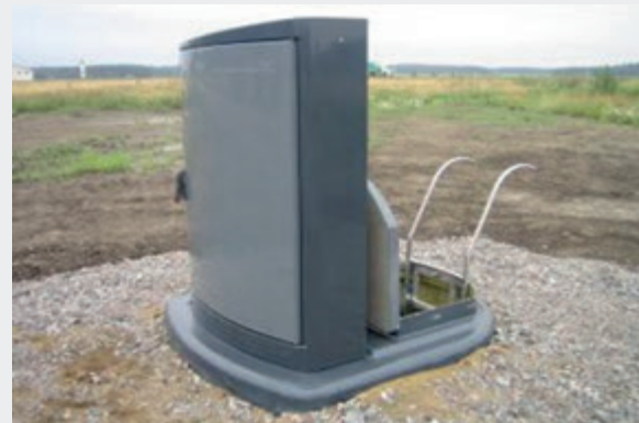
Рис. 19 Шкаф управления, установленный на увеличенной верхней крышке из стеклопластика.
