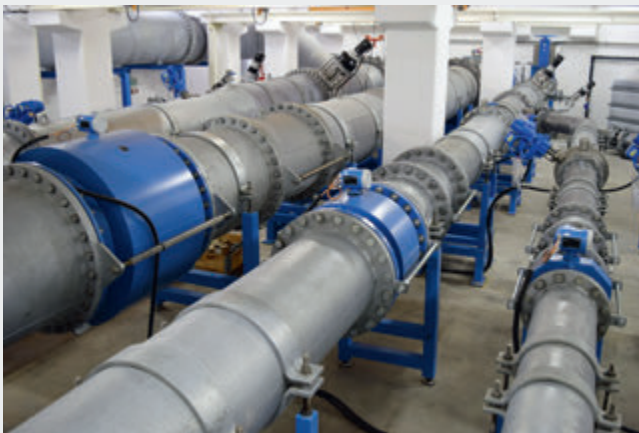
Рис. 6 Трубопровод и измерительное оборудование, установленное ниже уровня пола.
