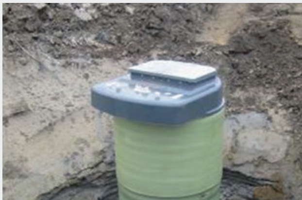
Рис. 18 Насосная станция с увеличенной верхней крышкой из стеклопластика, подготовленной для установки шкафа управления.
