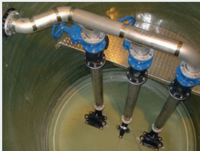
Рис. 28 Насосная станция \Phi 3000 мм с трубопроводной системой из нержавеющей стали со стационарной площадкой обслуживания.
