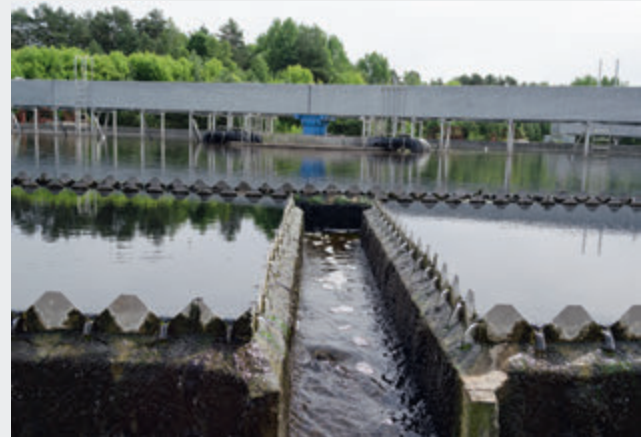
Рис. 2 Очищенные сточные воды, поступающие со станции очистки сточных вод в приемную систему.
