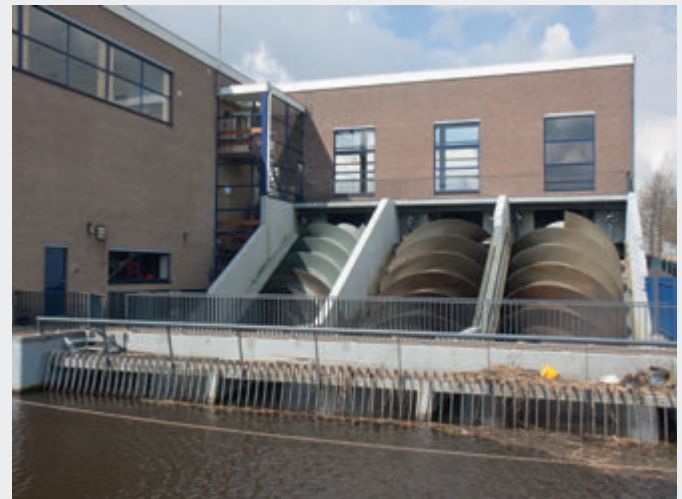
Рис. 5 Три насоса с Архимедовыми винтами в заборной насосной станции очистных сооружений.
