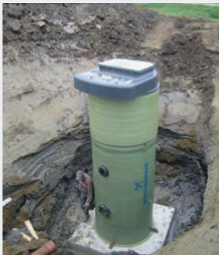
Рис. 1 Насосная станция диаметром 1 800 мм на бетонном фундаменте для предотвращения всплытия. Сверху станции устанавливается панель управления.
