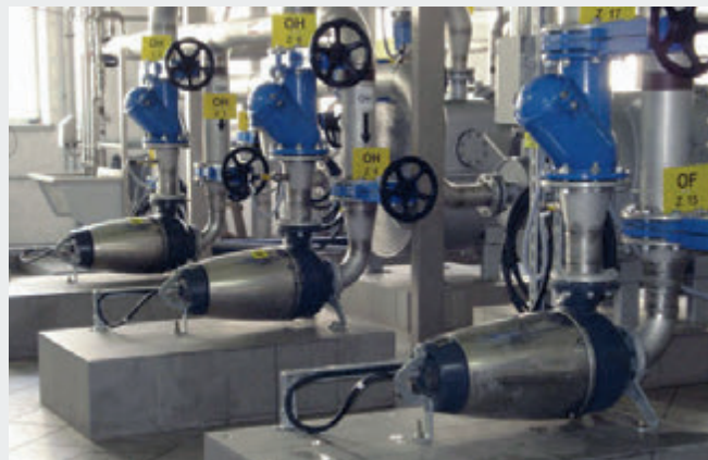
Рис. 3 Канализационные насосы Grundfos на отдельных фундаментах.
