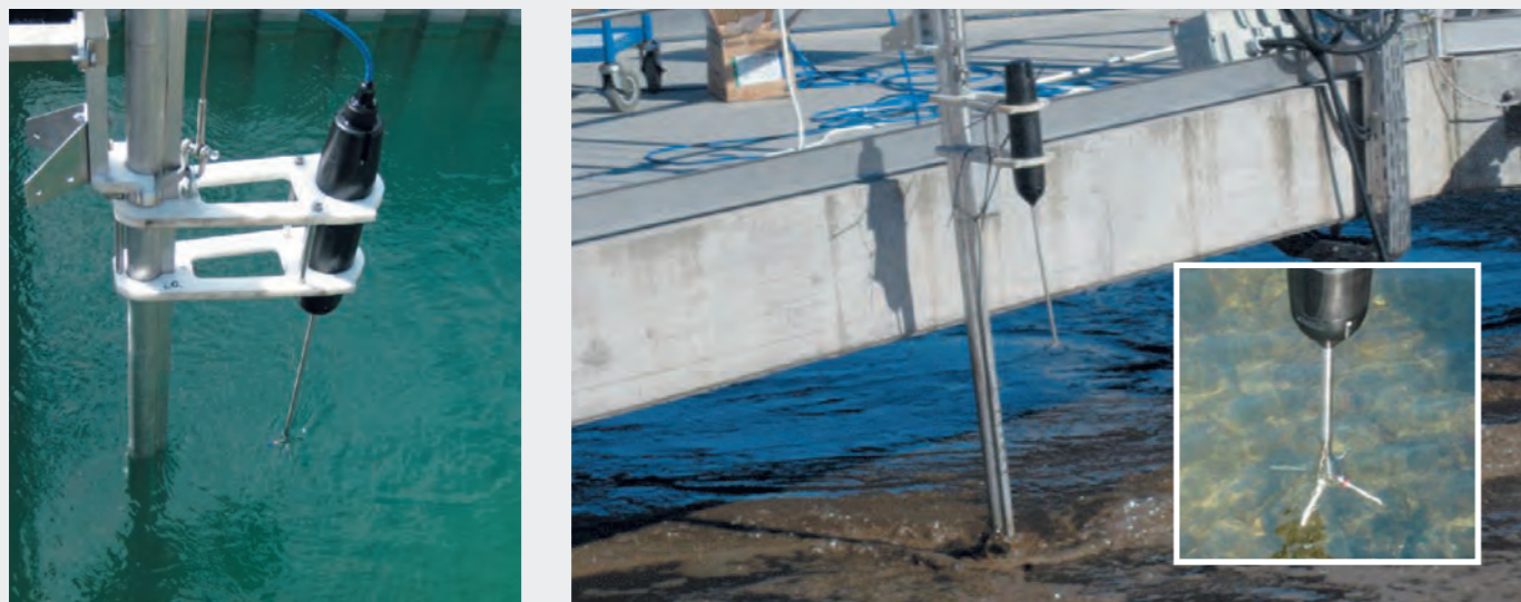
Рис. 33 Измерение скорости потока, выполняемое в реальных производственных условиях на станции водоочистки
