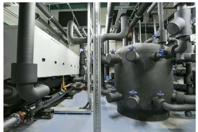
Agregat chłodniczy i jeden z trzech zainstalowanych dystrybutorów Zortström
