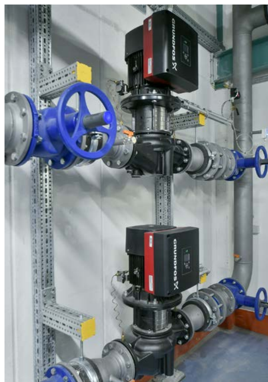
System pomp do pompowania wody chłodzącej do suchej wieży chłodniczej
