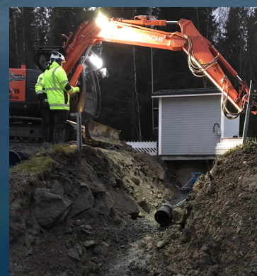
I Mustakorvenoja oppnådde de 60–70 % energibesparelser etter å ha installert en Wastewater Booster pumpestasjon
