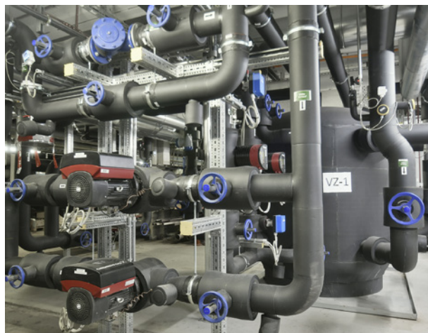
Neue Energiezentrale Kälte mit einem von insgesamt drei Zortströmverteilern und Kältepumpen
