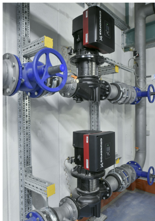
Pumpenanlage für die Förderung des Kühlwassers zum Trockenkühlturm
