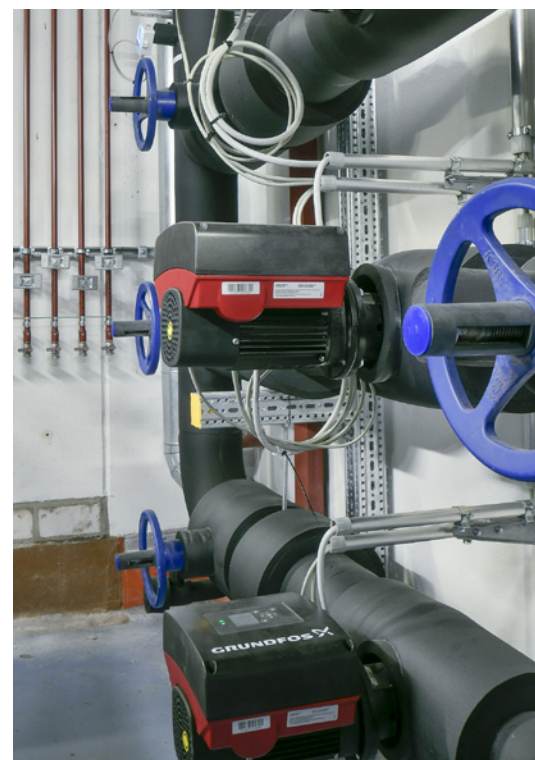
Kaltwasser-Pumpen für die Förderung des Kältemediums zum Zortström-Verteiler
