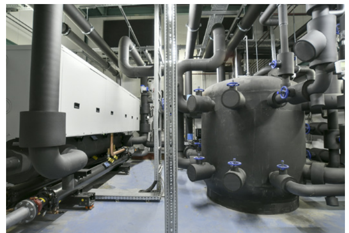
Kältemaschine und einer der drei installierten Zortström-Verteilern
