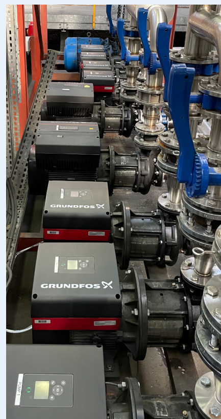
Grundfos NBE-pumpar för Suntory Beverage & Foods kylvattensystem.
