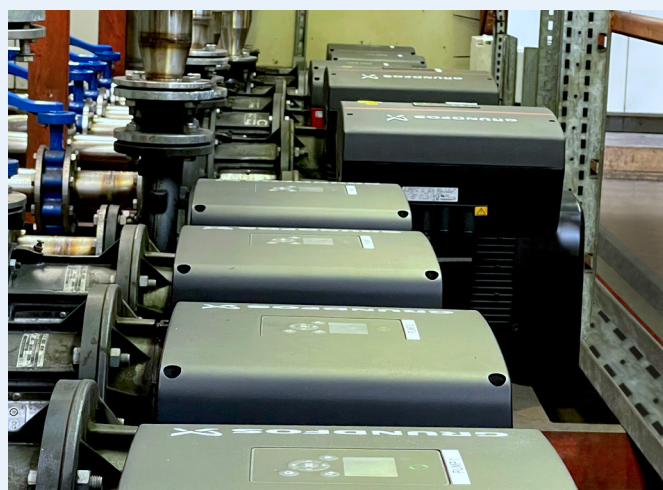
14 stycken dubbla Grundfos NBE-pumpsystem med 11 kW högeffektiva IE5-motorer körs med konstanttryckreglering i Lucozades centrala kylsystem.
