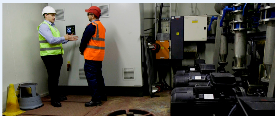
Stadens vattenreningsanläggning vid Suntory Beverage & Foods GB&I-fabriken
