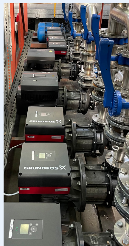
Grundfos NBE-pumper på Suntory Beverage & Foods kølevandsanlæg.
