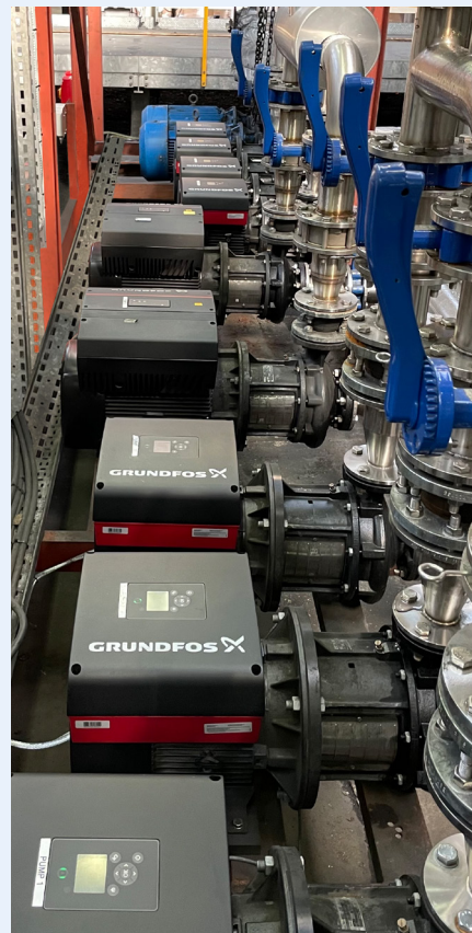
Grundfos NBE-pompen voor de koelwaterinstallatie van Suntory Beverage & Food.
