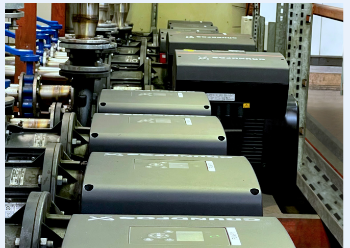
De Centrale Koeling voor Lucozade bestaat uit 14 tweepomps NBE-installaties van Grundfos met 11 kW hoogefficiënte IE5 motoren met constante drukregeling.
