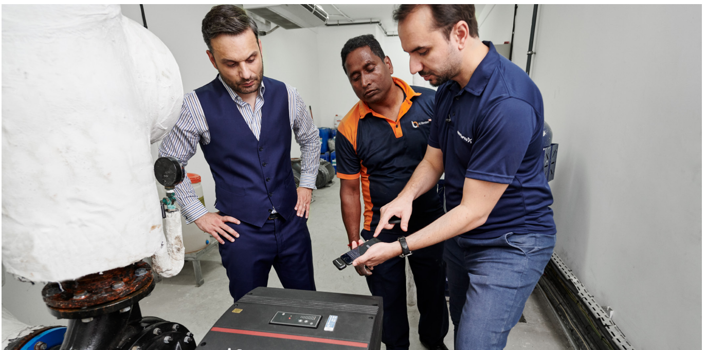
Vasileios Vatistas dari H&H (kiri) dan Manajer Fasilitas Indigo Tower belajar cara memantau pompa NBE Grundfos melalui aplikasi ponsel Grundfos GO dari teknisi Layanan Grundfos (kanan).
