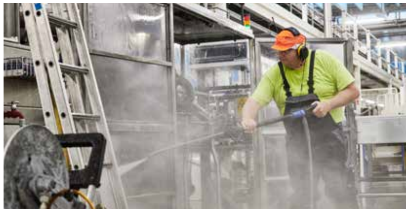
น้ำที่ใช้ในกระบวนการผลิตใช้สำหรับทำความสะอาดอุปกรณ์ พื้น พื้นผิว ท่อและถัง เครื่องสร้างขวดและกระป๋อง และอื่นๆ ภายในโรงงาน
